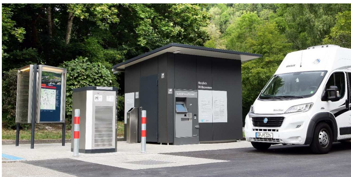
Serviceraum mit Parkscheinautomat, Sani Station, Bodeneinlass zur Grauwasser Entsorgung
